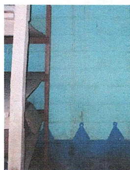
Foto 2: Paredes interior con presencia de humedad.
