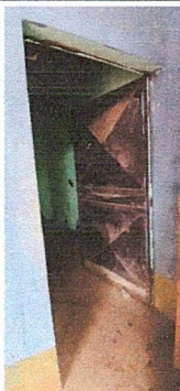
Foto 3: Puerta de bodega deteriorado.
